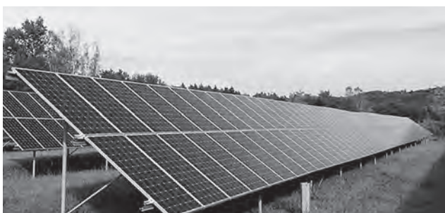
太陽光発電設備
