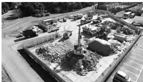
災害廃棄物置場（元年台風時）
