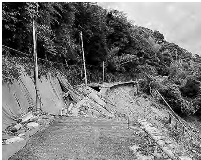
市道和田6号線崩落箇所
