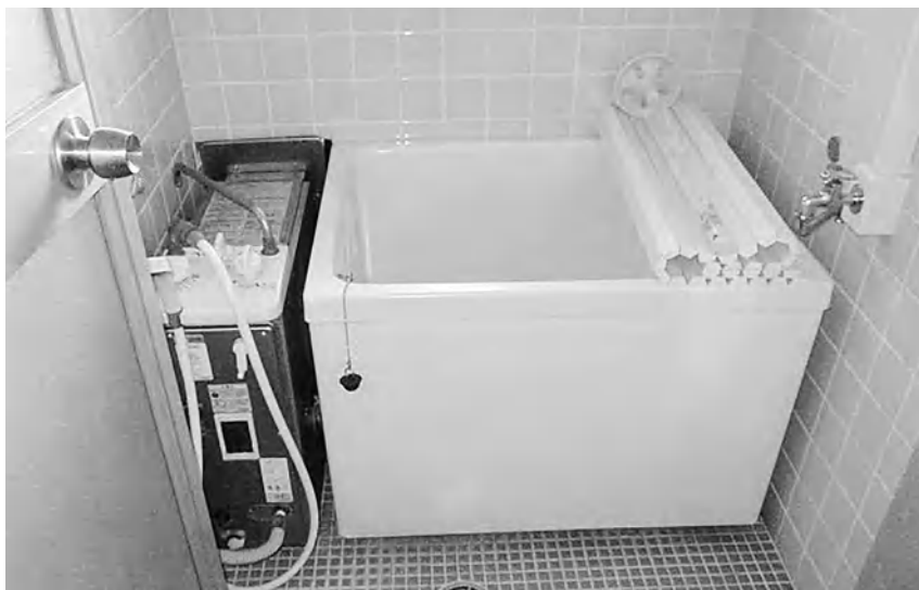
市営住宅・南三原団地の浴槽給湯設備
