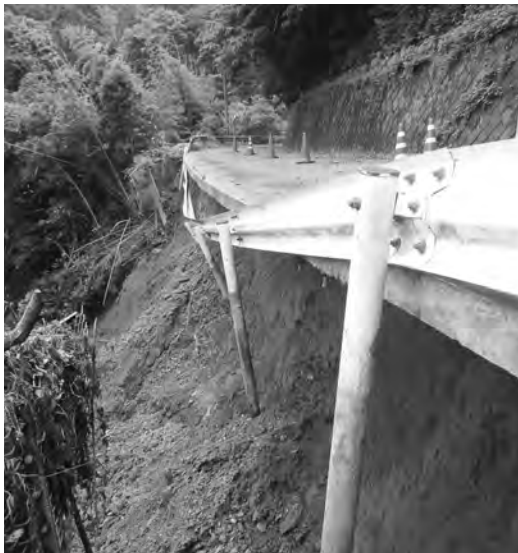
崩落した市道和田6号線
