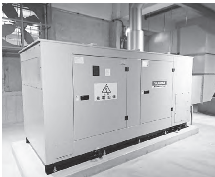
浄水場の自家発電機
