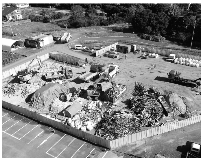
災害廃棄物仮置き場
