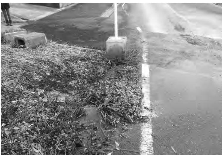
土砂で詰まった側溝
