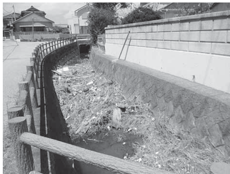
台風により土砂や流木で詰まった河川
