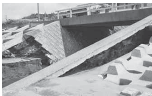
昨年の台風被害で修復を待つ、富浦町南無谷海岸（無名橋付近）
