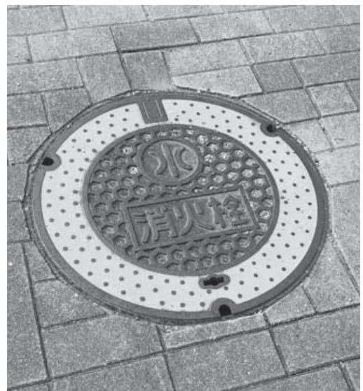
市内の消火栓
