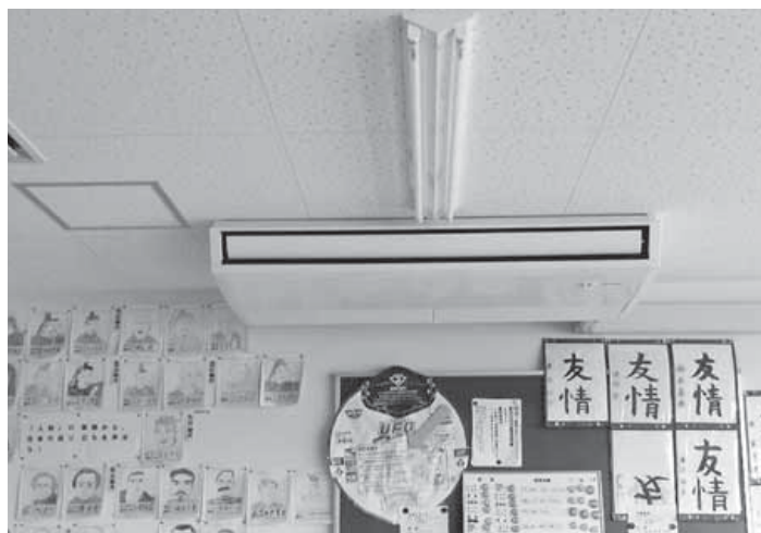
教室に設置されたエアコン
