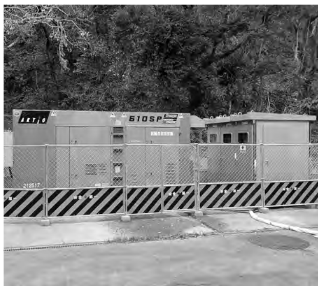
小向浄水場に設置された仮設発電機
