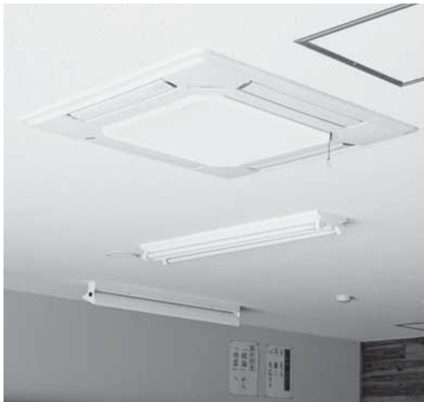
嶺南中の普通教室に設置されたエアコン
