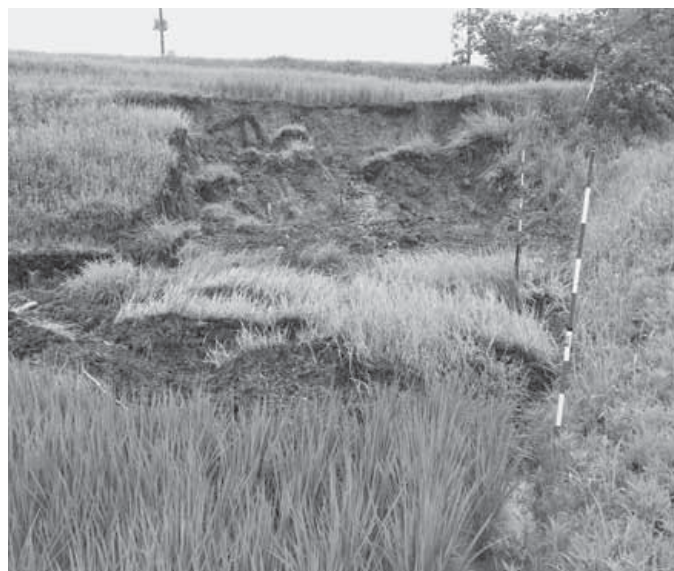
豪雨により被害を受けた農道
