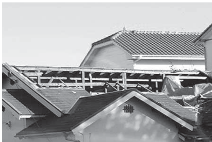
台風で被害にあった民家の屋根
