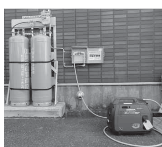
広域避難所のガス発電機。災害時には、土台にガスボンベを設置して使用
