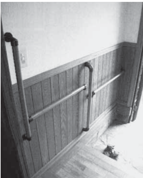
介護保険の住宅改修で設置された手すり
