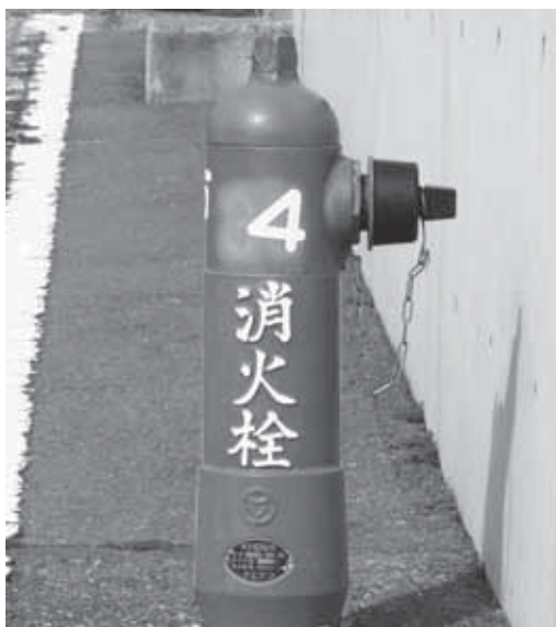
地上式消火栓
