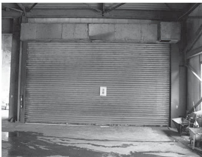
強風被害を受けた白浜清掃センターのシャッター
