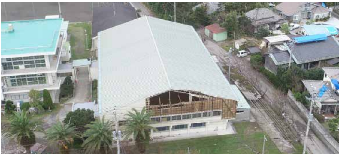
令和元年台風による被害
