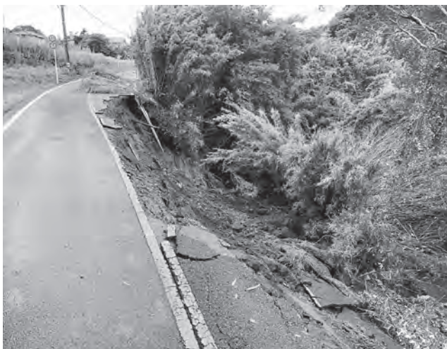
台風被害を受けた市道千倉4号線
