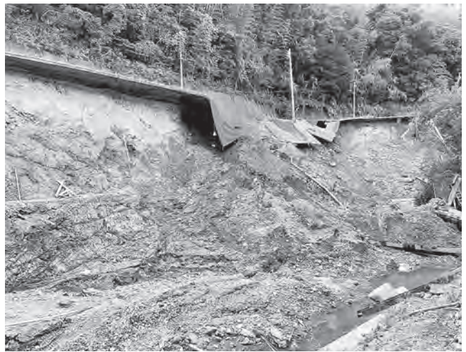
和田6号線の崩落箇所
