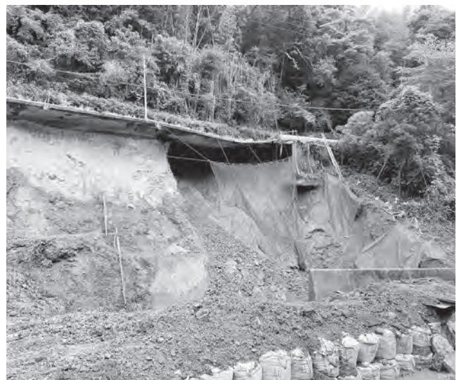
9月に再崩落した市道和田6号線
