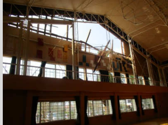
令和元年台風第15号による建物被害 (富浦中学校体育館)
