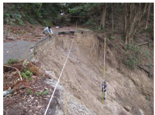
令和元年10月25日台風による崩壊 (嶺岡中央林道)
