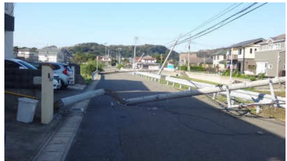
令和元年台風第15号による電柱倒壊 (富浦町多田良地区)
