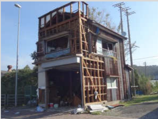
令和元年台風第15号による建物被害 (市消防団詰所(富浦地区))
