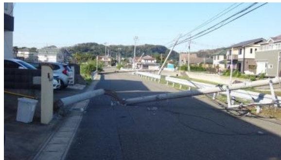
令和元年台風第15号による電柱倒壊 （富浦町多田良地区）
